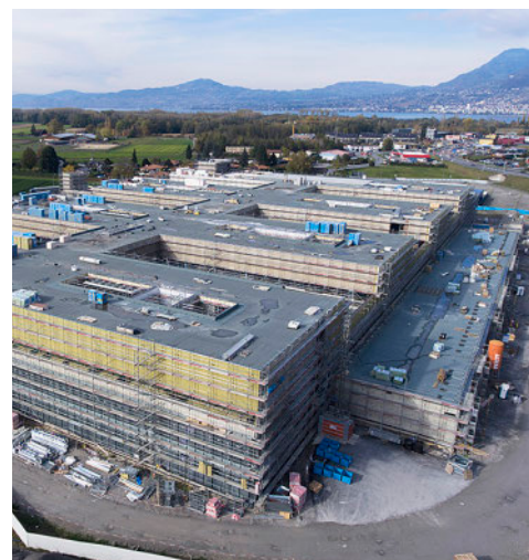
La construction du nouvel hôpital Riviera-Chablais engendrera de nombreux changements organisationnels. Photo: Hôpital Riviera-Chablais
